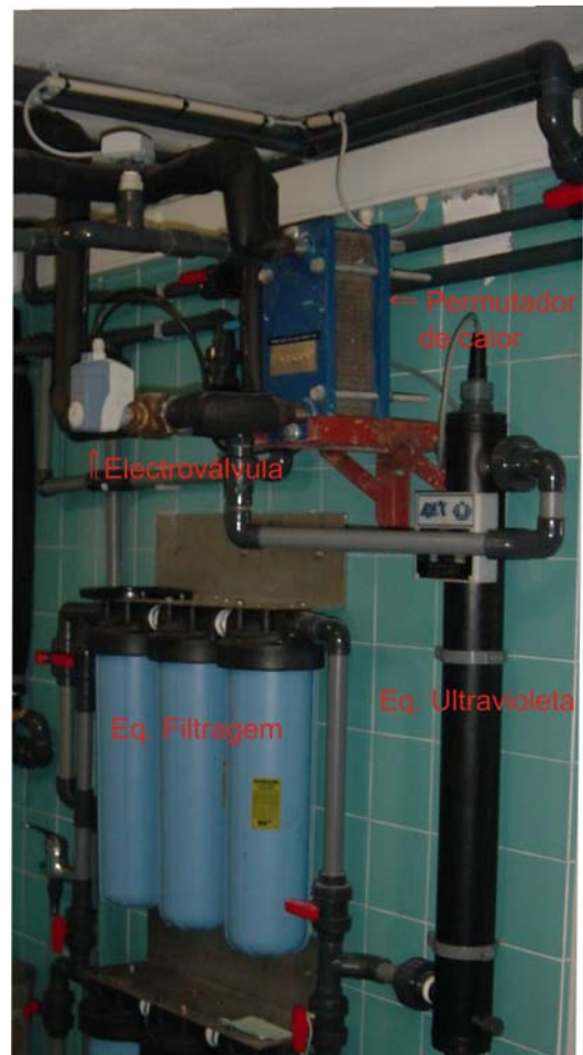
Figura 24 – Sistema de filtração e aquecimento de local água.
