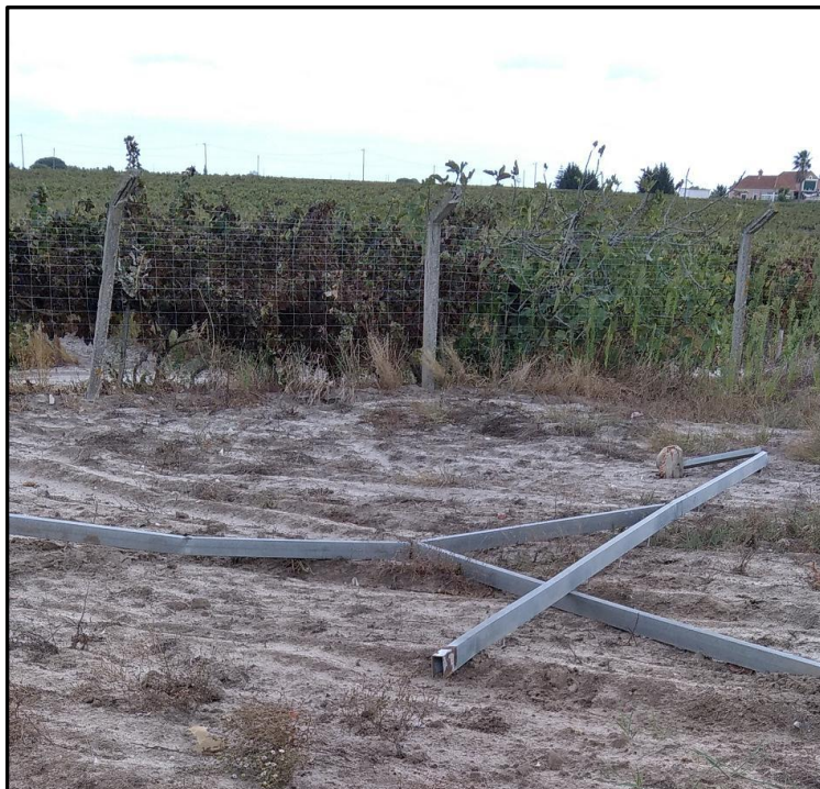
Figura A12 –Estruturas de telheiro metálico arrancadas (Ponto T5).
