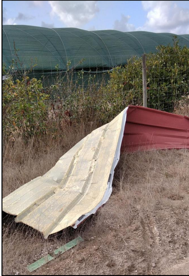
Figura A13 – Placas de tipo sanduiche de telheiro metálico (ref. Fig A12) projetadas a grande distância (Ponto T5).
