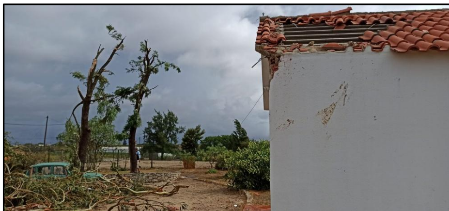
Figura A3 – Telhas levantadas (detalhe da Fig A1).
