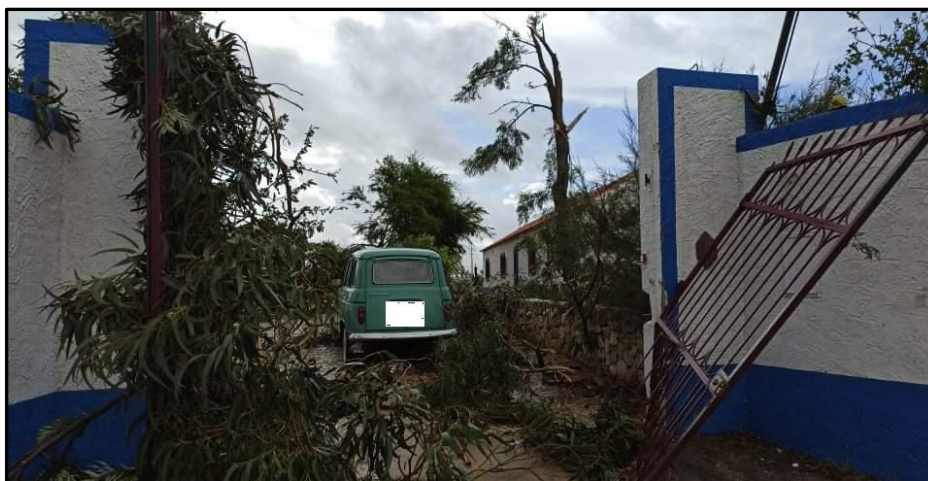
Figura A7 – Portão principal torcido e parcialmente arrancado (ponto T4).
