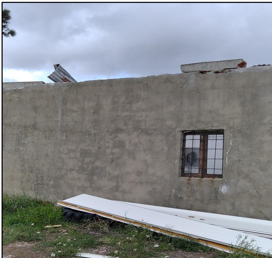
Figura A17 – Destelhamento total de anexos de apoio à atividade agrícola (Ponto T5).
