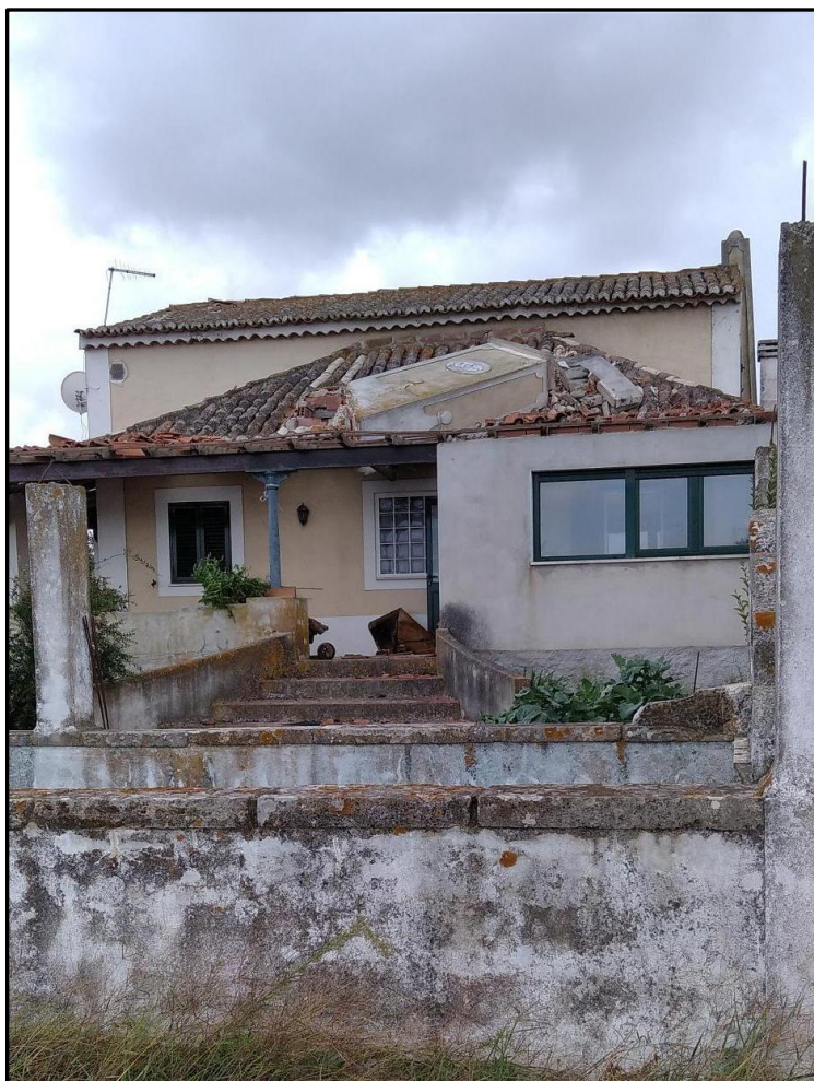
Figura A10 - Chaminé principal da casa arrancada (Ponto T5).
