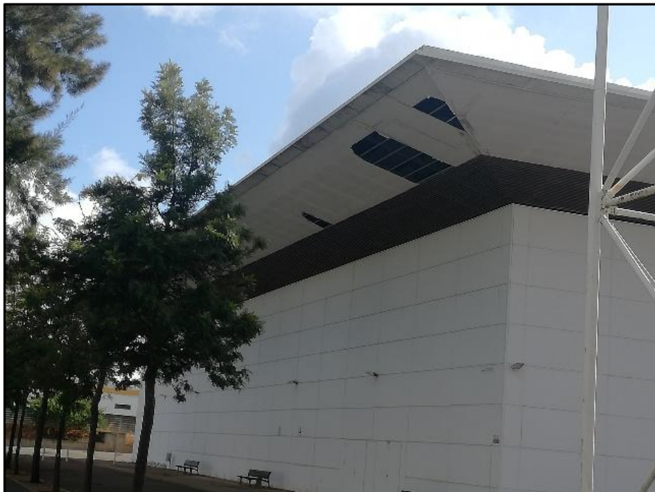
Figura A19 – Queda de estruturas metálicas e danos em coberturas, Pavilhão dos Sabores (Ponto do trajeto de destruição T2).
