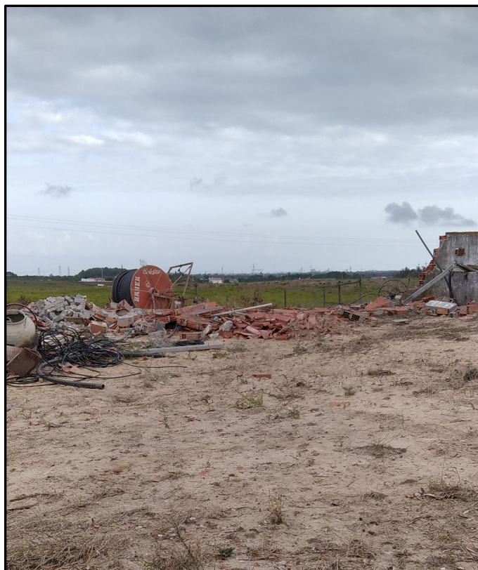
Figura A4 - Muro de separação da propriedade (em tijolo) derrubado em grande parte da sua extensão (ponto T4).
