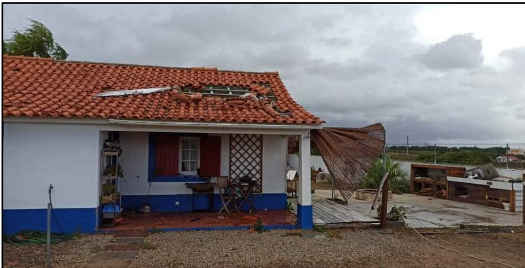
Figura A2 - Telhas levantadas noutra área do telhado expondo as vigotas (ponto T4).
