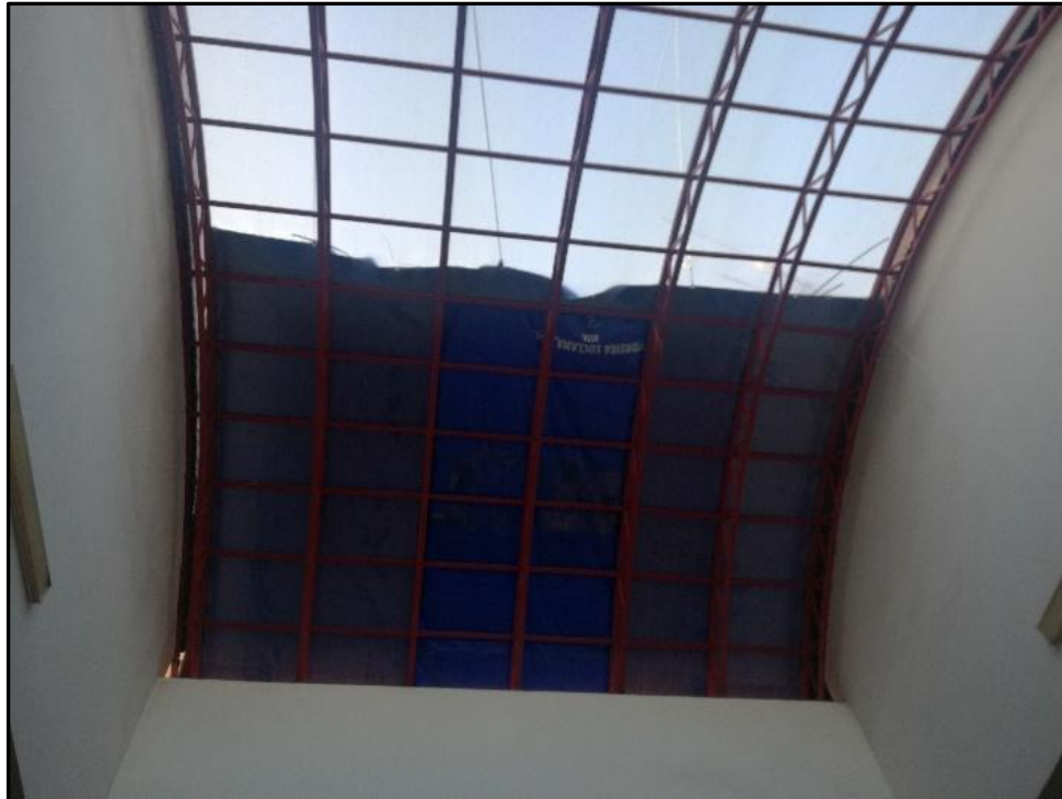
Figura A20 – Lonas de ensombramento arrancadas, Escola Mário Beirão (Ponto T3).
