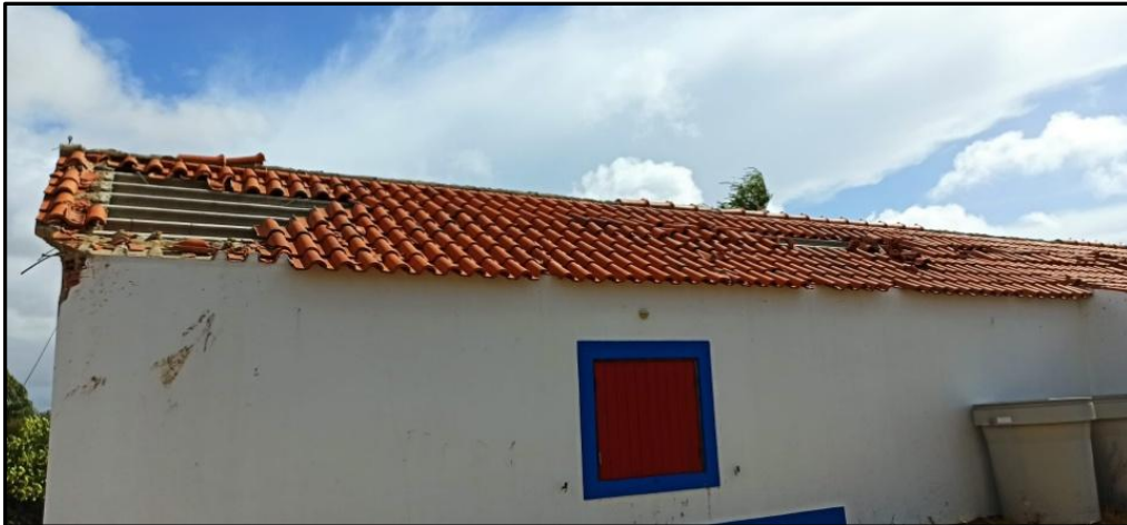
Figura A1 - Telhas levantadas em diversas áreas do telhado expondo as vigotas (ponto T4 do trajeto de destruição).
