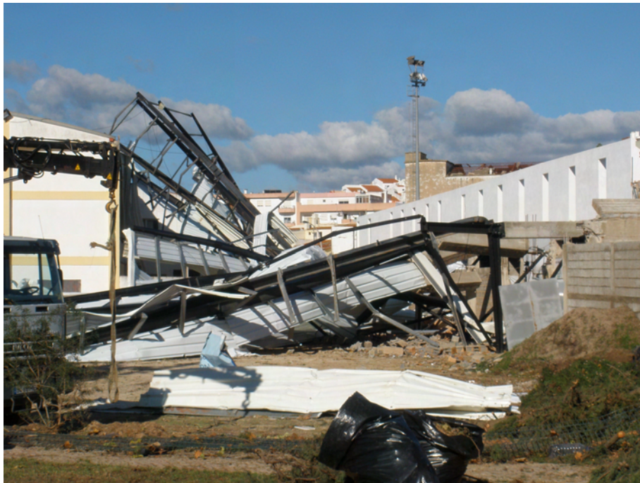
Fig H – Estrutura de suporte da pala da bancada do estádio Dr. Francisco Vieira completamente destruída (Ponto 4, Fig 1).
