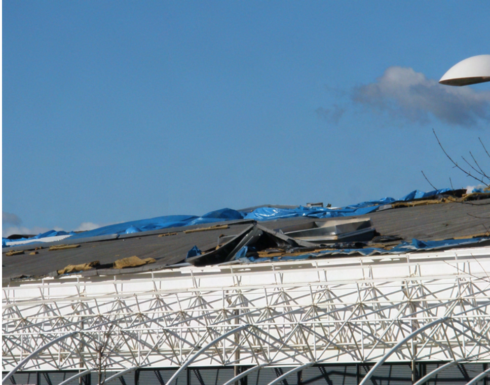
Fig G – Danos da cobertura das piscinas de Silves (Ponto 4, Fig 1).
