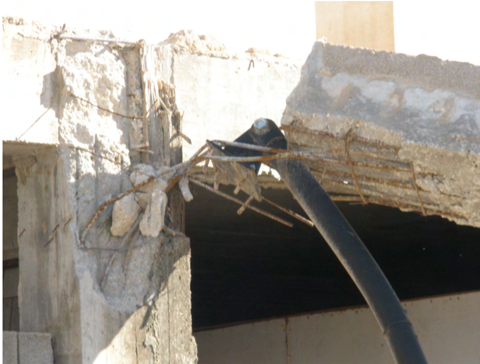
Fig I – Detalhe de pilar em betão quebrado pelas forças envolvidas (Ponto 4, Fig 1).
