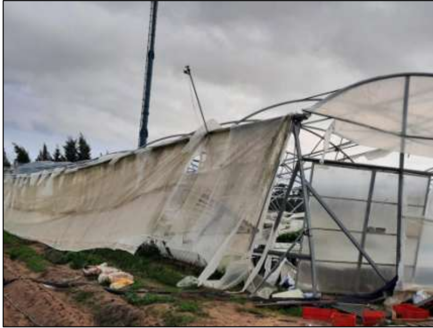
Figura A3 – Destruição em estufa (Figura 6, ponto P2; fonte: Sr. Manuel Bolieiro).
