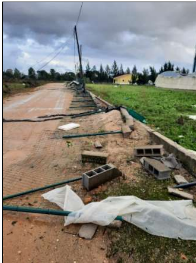
Figura A4 – Vedação metálica chumbada, arrancada numa extensão de várias dezenas de metros (Figura 6, ponto P2; fonte: Sr. Manuel Bolieiro).
