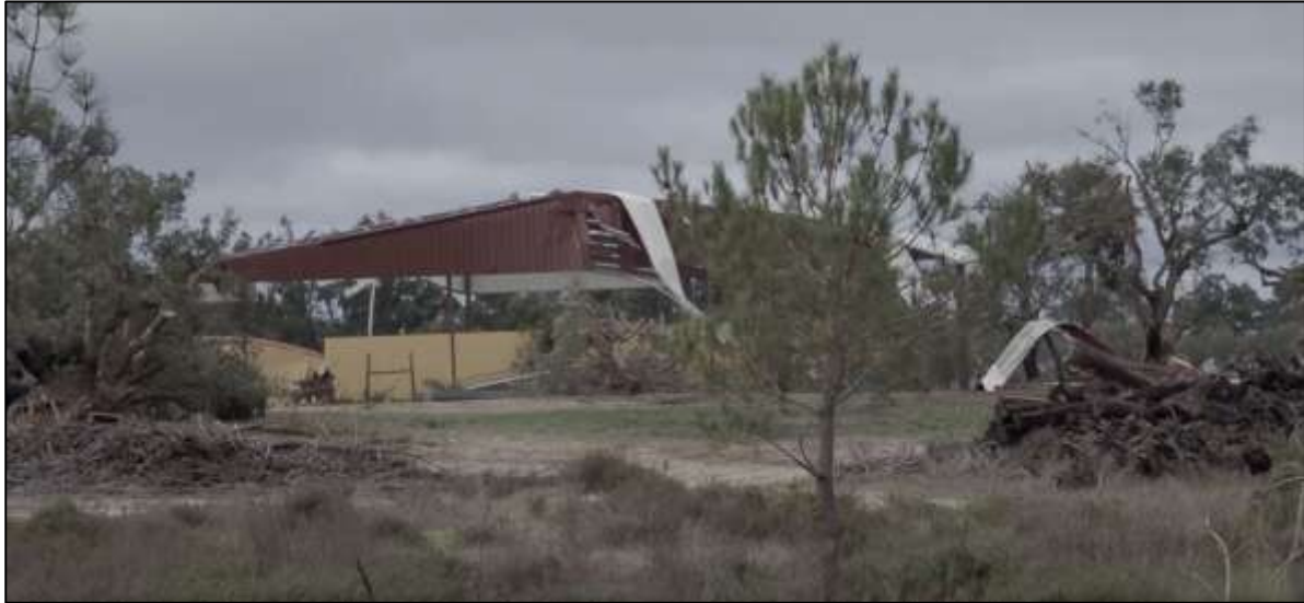
Figura A1 – Telheiro metálico de grandes dimensões danificado (Figura 6, entre P1 e P2; fonte: “Notícias do Sorraia”).
